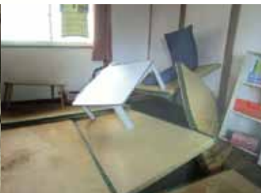
屋内の状況、泥水流入でめくれ上がった畳
